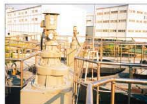
化學工廠刮泥設備
