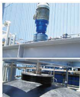
化工儲槽(格蘭軸封)
