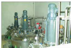
生化科技設備
